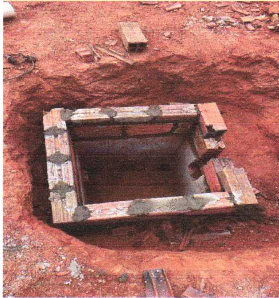
FOTO 133: CAIXA DE GORDURA
