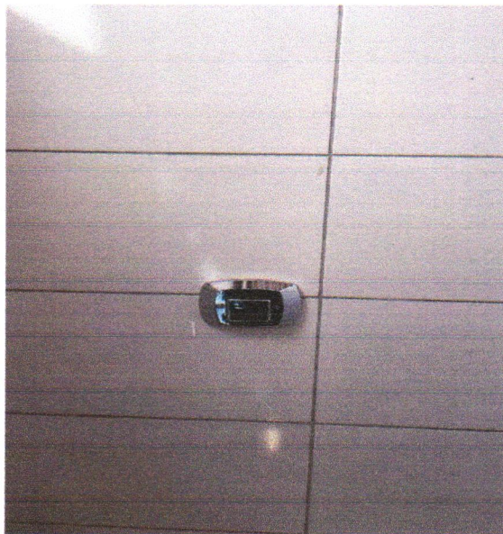
FOTO 118: VÁLVULA DE DESCARGA METÁLICA
